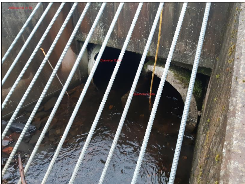
Figur 21: Innløp til stikkrenner ved Skytta barnehage
