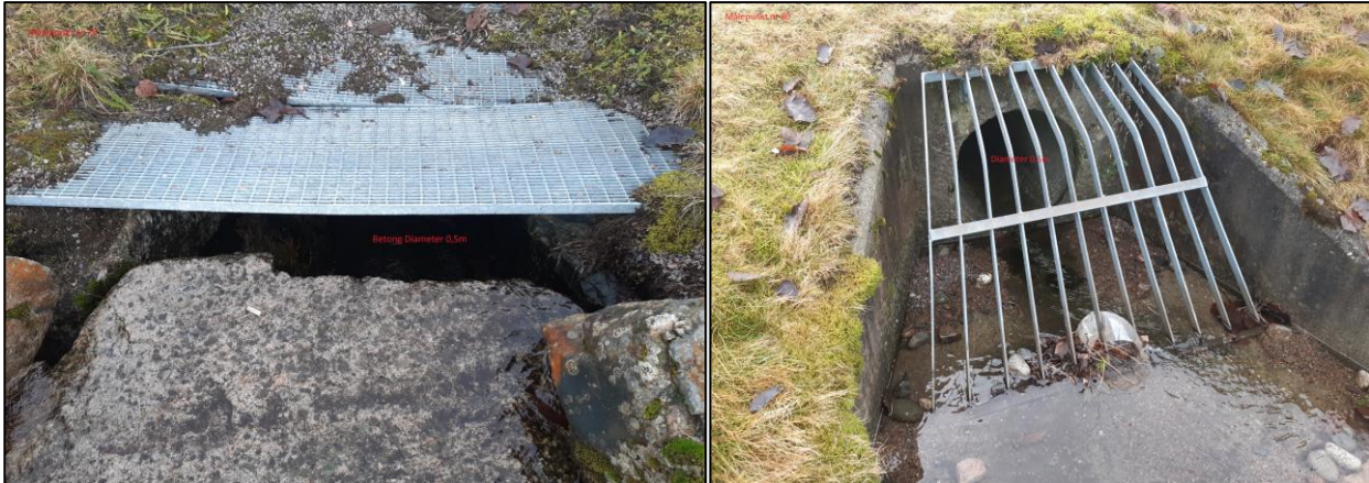
Figur 24: Stikkrenne under Bevregrasveien, innløp til venstre og utløp til høyre
