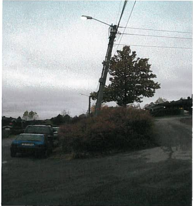
Bilde: Skjev mast, Liljeveien.
