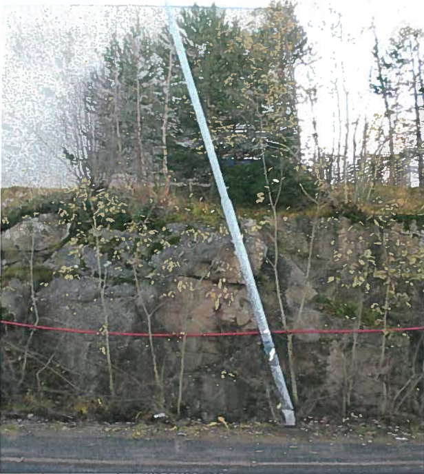
Bilde: Påkjørt lysmast, Industriveien.
