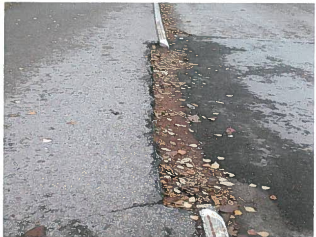
Bilde: Manglende kantstein fortau, Sørliveien.
