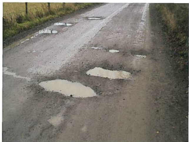
Bilde: Hull i grusdekke, Brennløkkeveien.
