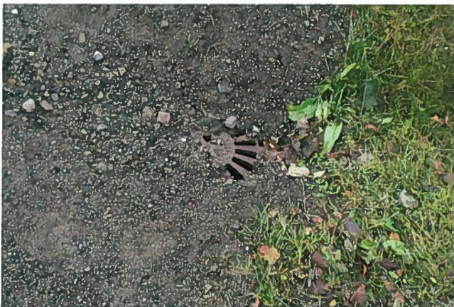
Bilde: Delvis tilgrodd og overfylt grøftesluk, Rådyrveien.
