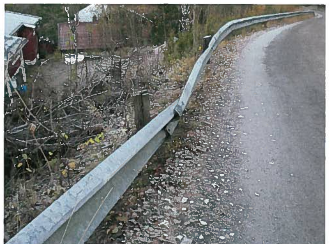
Bilde: Ødelagt rekkverk, Gamle Trondheimsvei.
