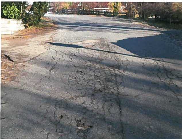
Bilde: Oppsprukket veidekke, Brennalìa.
