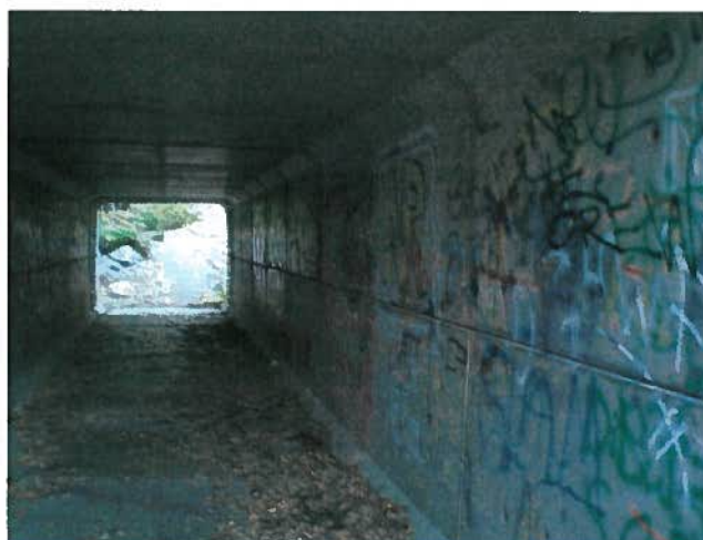
Bilde: Tagging og graffiti samt manglende renhold av undergang, Morteveien.
