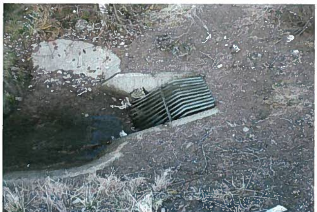
Bilde: Bekkeinntak, manglende rensk, Blåtoppveien.
