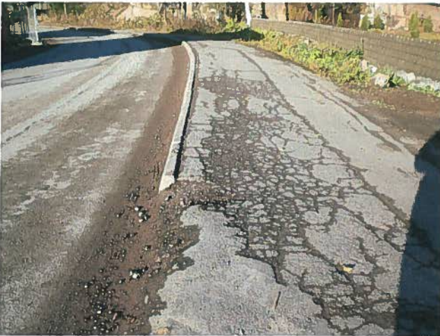
Bilde: Fortau med ødelagt kantstein og dårlig asfalt, Carl Bergersens vei.
