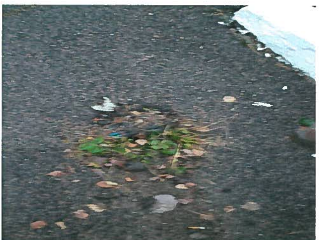
Bilde: Ødelagt og igjengrodd slukrist, Kobberveien.
