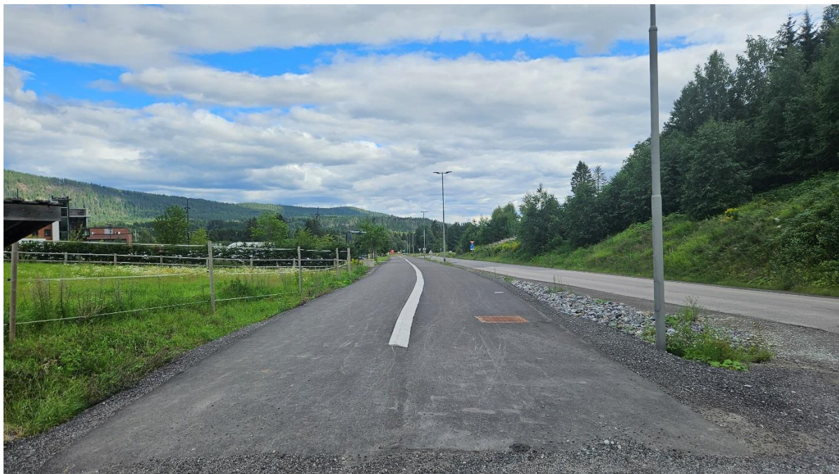
Første del av gang- og sykkelvei med separate felt langs Svartkruttveien ble bygget i 2022. Siste etappe opp til Kvernstua ble bygget ferdig høsten 2023.
