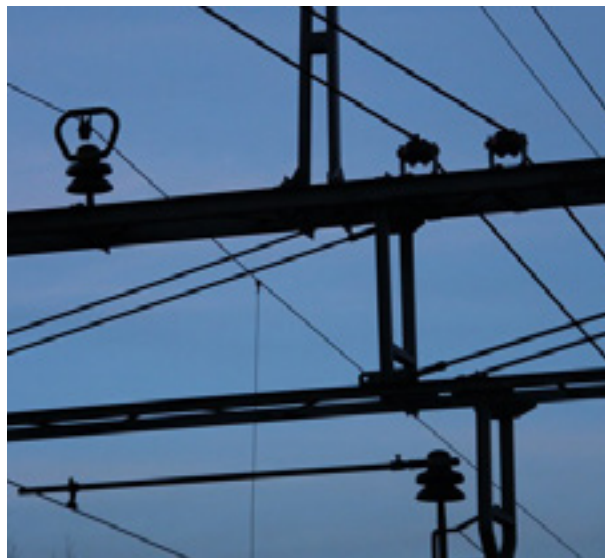
Elektriske kabler, Hakadal Stasjon
