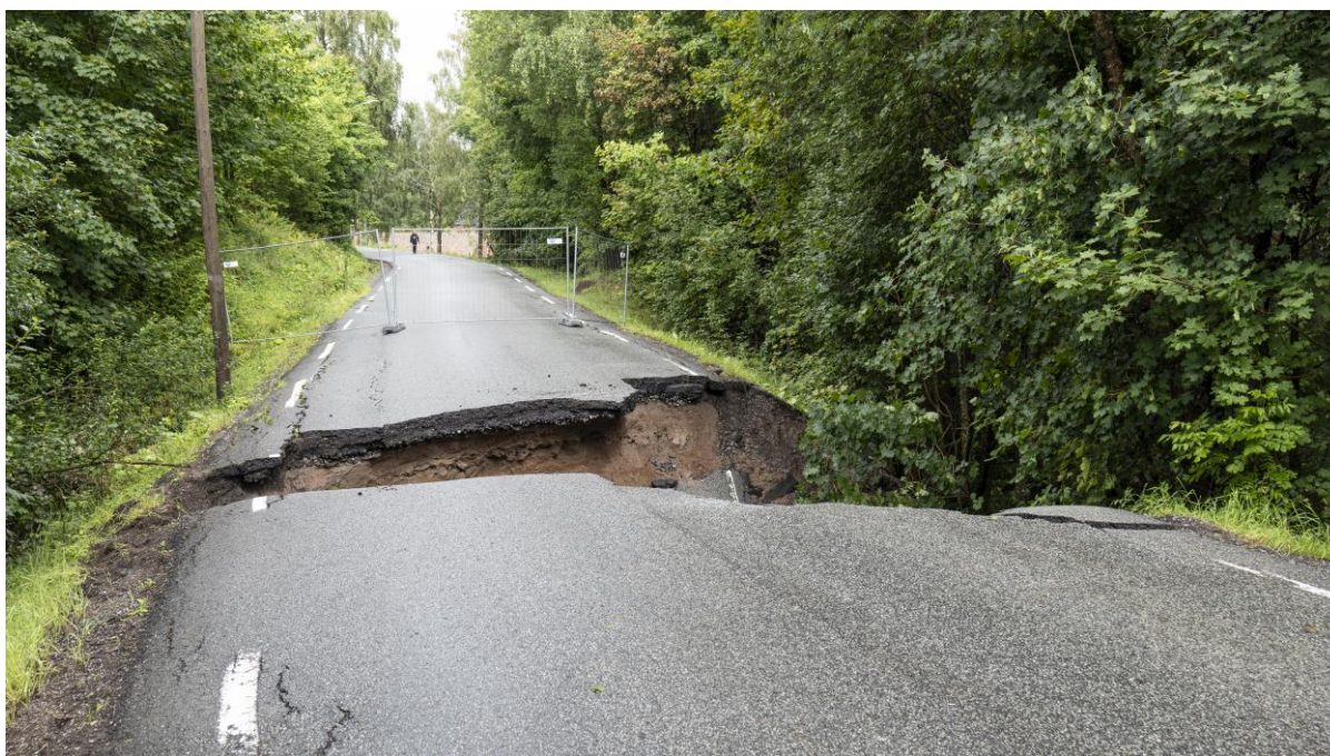
Ekstremværet "Hans" i august 2023 gjorde skade også i Nittedal, her fra Sagstuveien nord for Hakadal stasjon.
