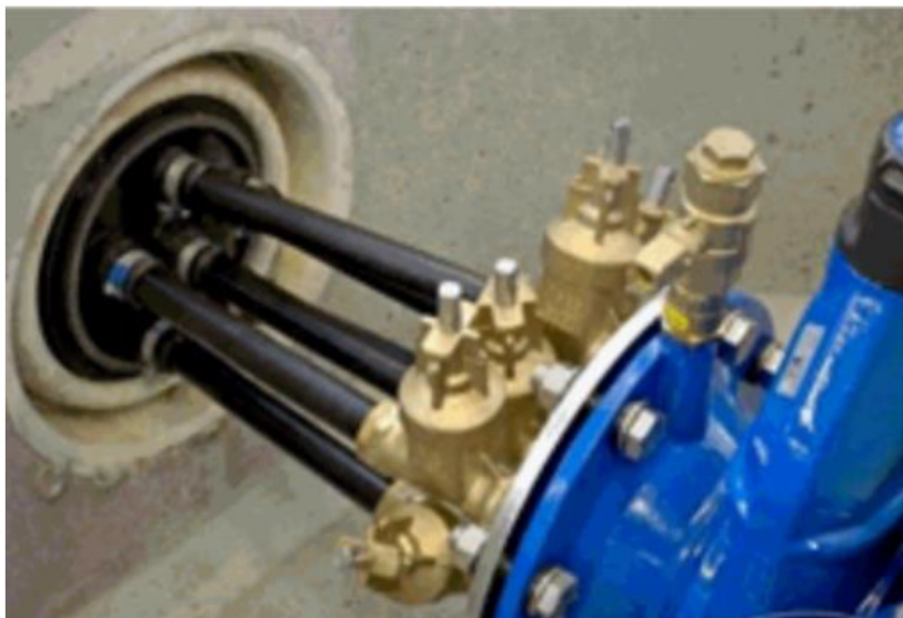
Figur 9. Eksempel på stikkledninger som ligger buntet sammen
